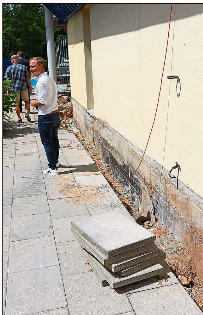
Energetisch und technisch soll das Minara auf dem neusten Stand sein. Die Gräben für die Wärmedämmung sind bereits gelegt.
