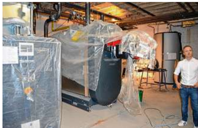
Vorn links befindet sich im Untergeschoss das neue Blockheizkraftwerk, daneben hat die neue Heizung ihren Platz gefunden.
